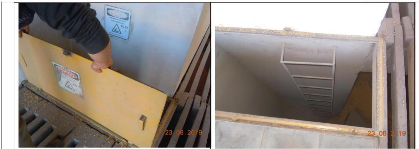
Figura 13. Ausência de ancoragem para sistema de resgate e ausência de sistema de linha de vida
