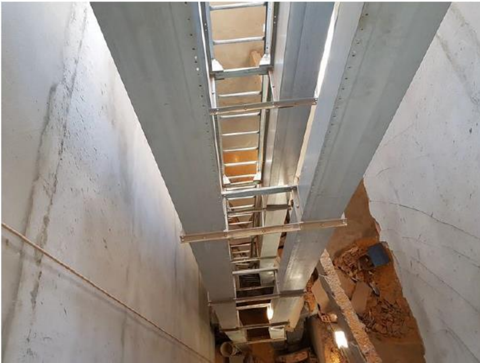
Foto da parede que ruiu e poço do elevador de grãos.
